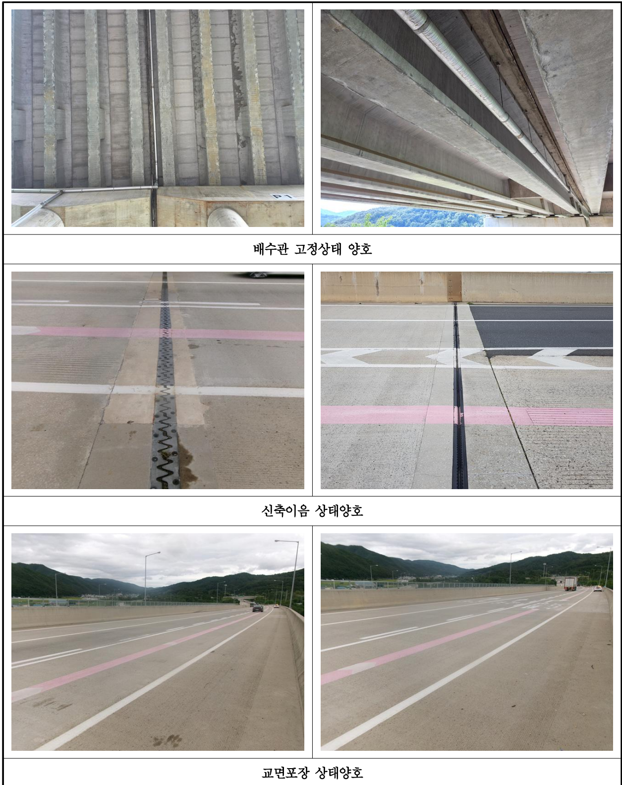
【사진 14.3.51】 교량의 공중이용시설 10대 위험요소 손상현황(계속)
